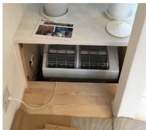
写真1 床下エアコン設置状況
