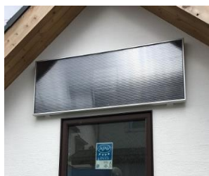
写真2 壁に取り付けられた太陽熱集熱器
